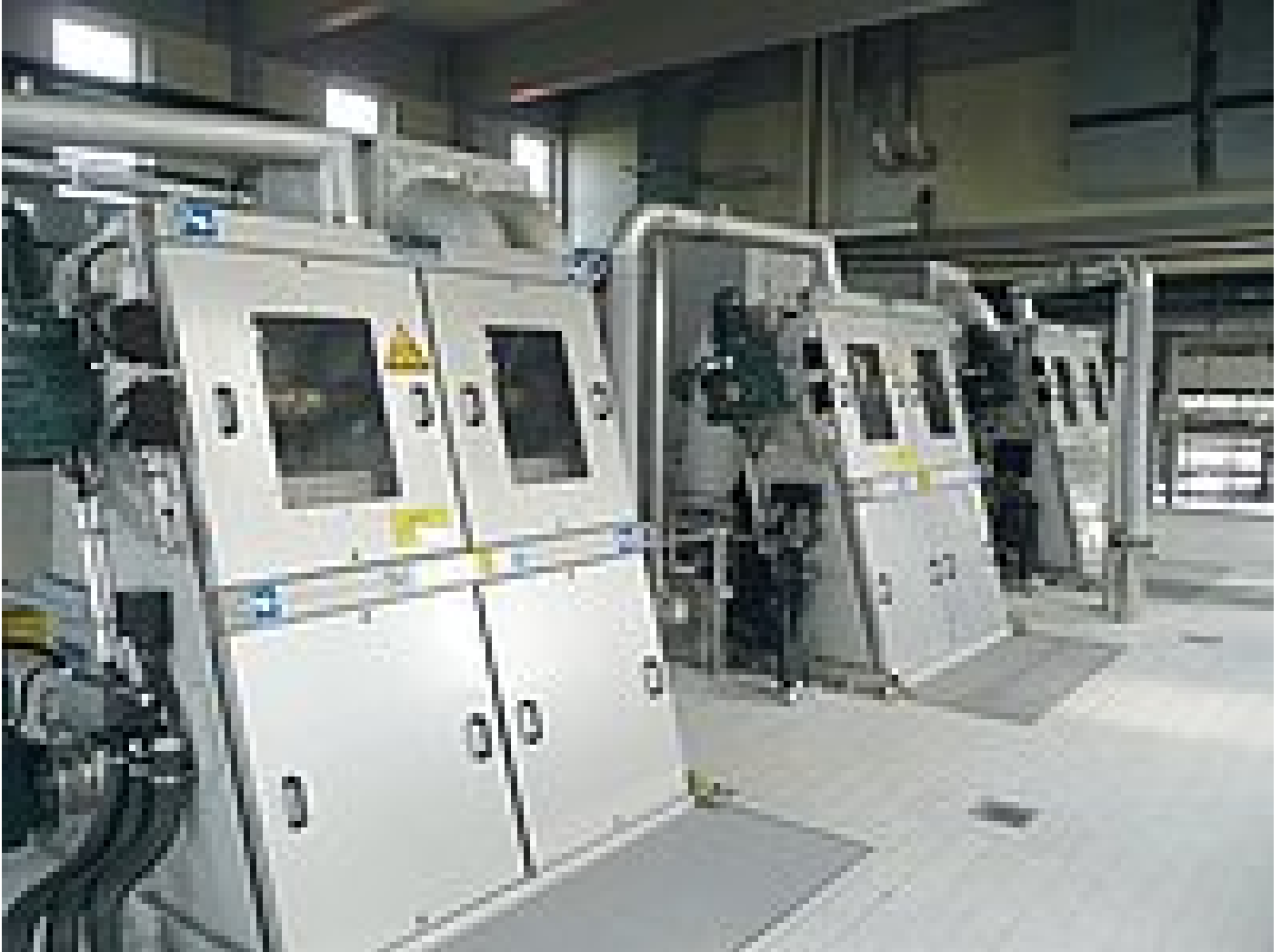
Three HUBER RakeMax® screens on WWTP Magdeburg/Gerwisch
